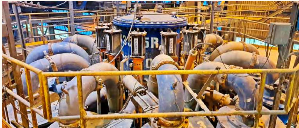
Figura 1. Sensor acústico en el overflow de cada hidrociclón.
